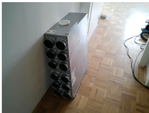
Razdelilec za dovode in odvode zraka, 2 x 6 priključkov za 2 x 150 m 3 /h.
