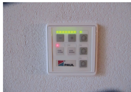
Elektronsko krmiljenje delovanja rekuperatorja. Dodatno se lahko na regulacijo priključi tipke (v kuhinji, kopalnici, WC-ju) za občasno (15-20 minutno) maksimalno moč delovanja ventilatorjev.
