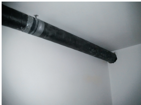
Zajem zraka iz izolacijskih cevi: potek med fasado preko kuhinje do utilitija, kjer je rekuperator.
