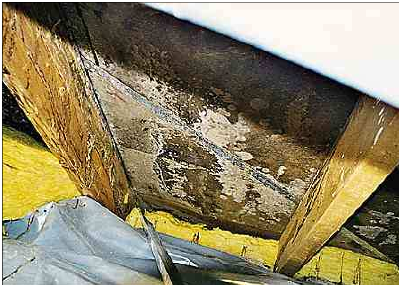
Abb.: Poškodbe vlage na podstrešju
